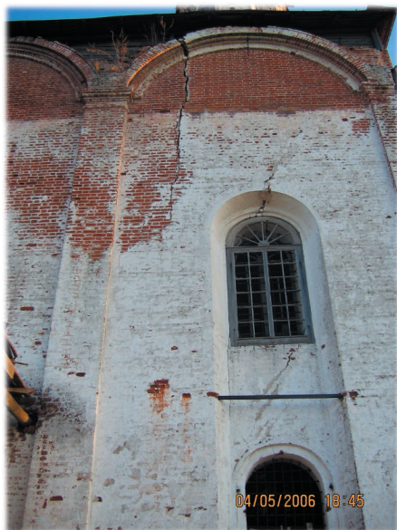
Просадочные трещины западного фасада Успенского собора Флорищевой пустыни в результате разрушения фундаментов
