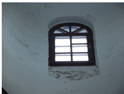
Пластиковое окно в храме и следы разрушения штукатурки Пластиковое окно в барабане храма
